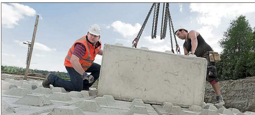
Ein Bauingenieur und ein Arbeiter setzen Steine für eine Probelastungsmessung. FOTO DPA
